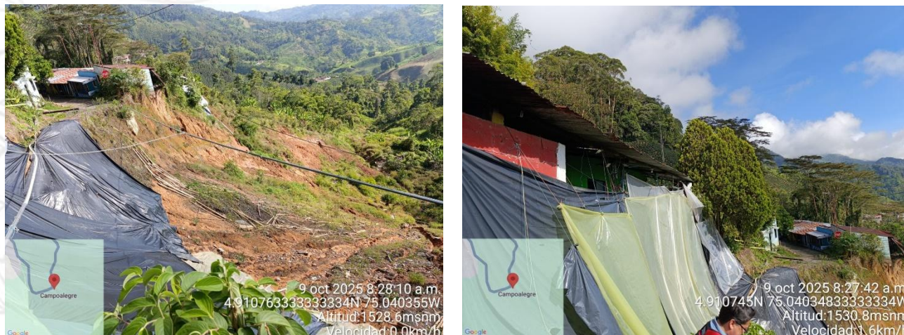
Imagen 5. Remoción en masa, vivienda vereda campo alegre.
